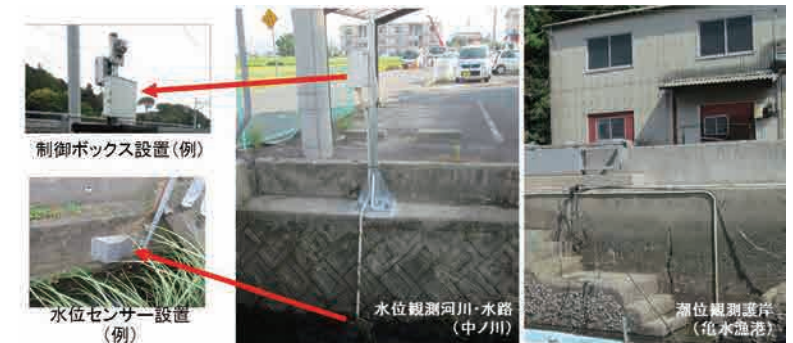
水位センサー等の設置イメージ 出典：高松市
